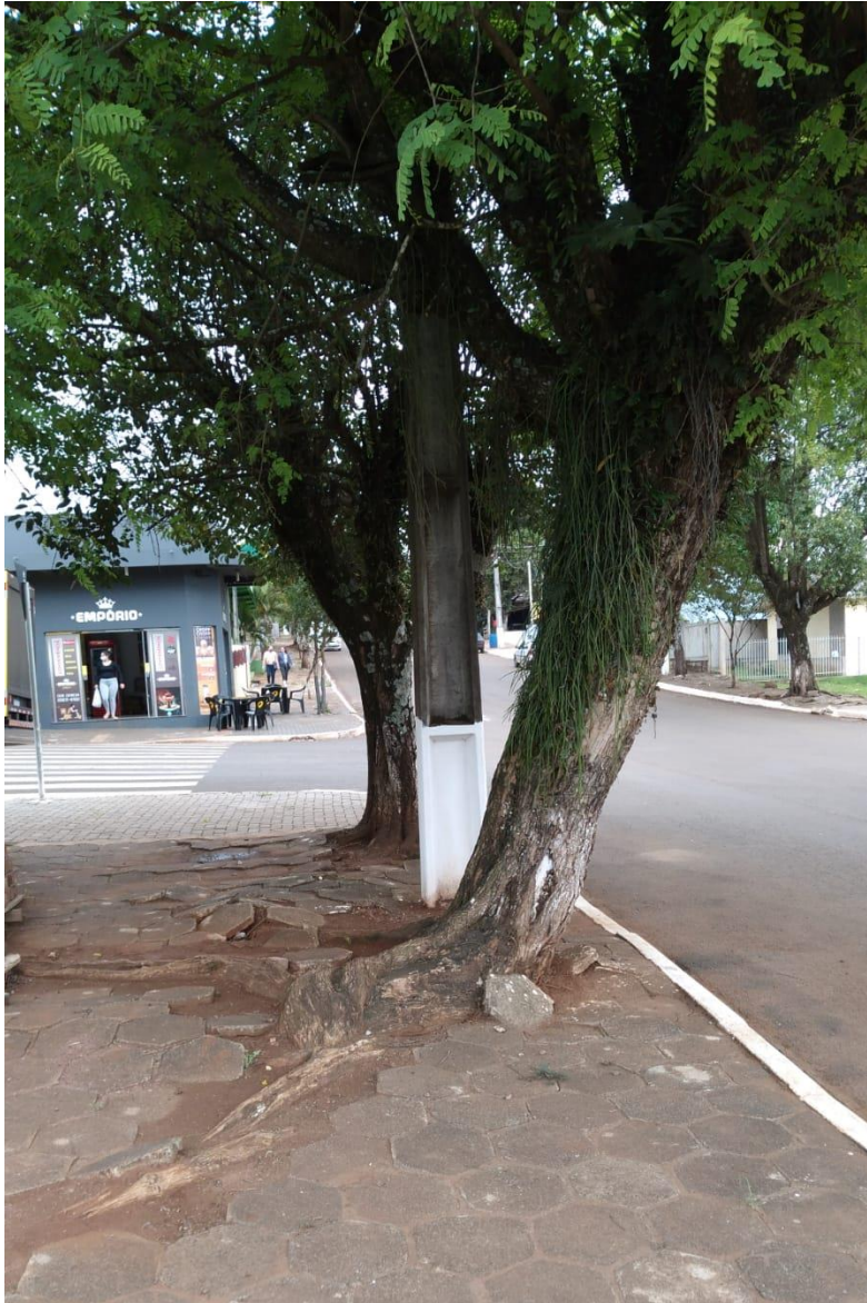
Figura 12 - Calçada danificada por raízes agressivas. FONTE: Autoria própria, 2021.
